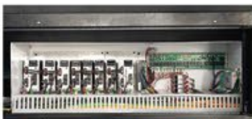
Sistema eléctrico industrial integrado
